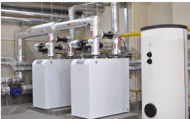
Kotłownia w ZSP Bestwinka
